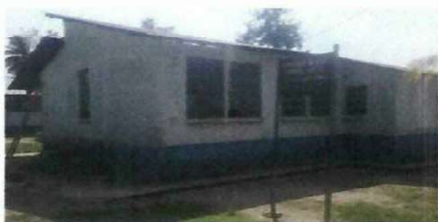
Foto 3: MODULO 3 Cambio de algunos vidrios quebrados de la ventana
